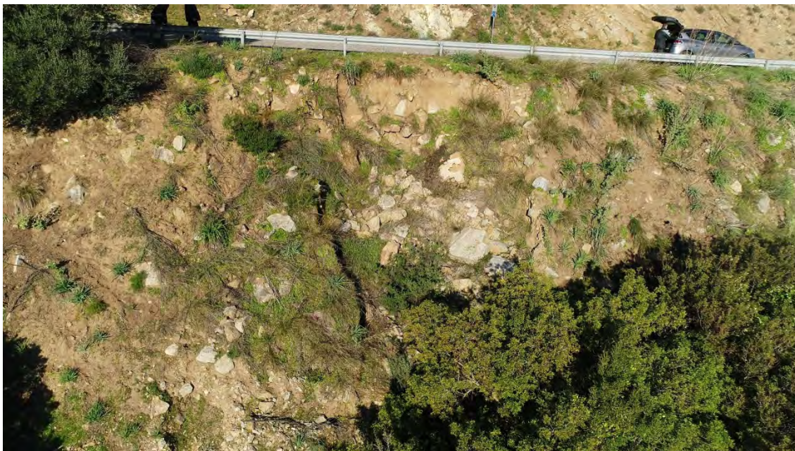
Dissesti in corrispondenza del km 19+030 della SP 50
